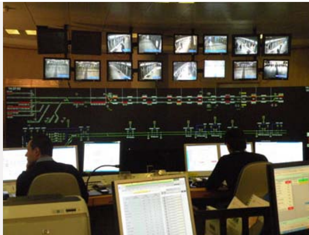
Sala de control de la red de metro.
