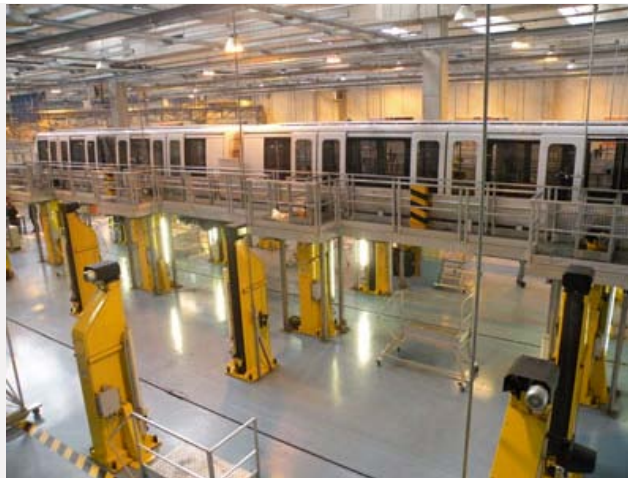
El taller de mantenimiento incluye 7 líneas de mantenimiento, con un elevador con 8 cilindros hidráulicos, una pasarela para trabajar sobre el techo de los trenes y mármoles para comprobar el nivel de los trenes y revestimientos que simulan la vía.
